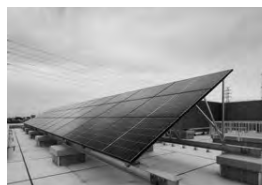
写真1 太陽光発電設備 (古河労働総合庁舎)
