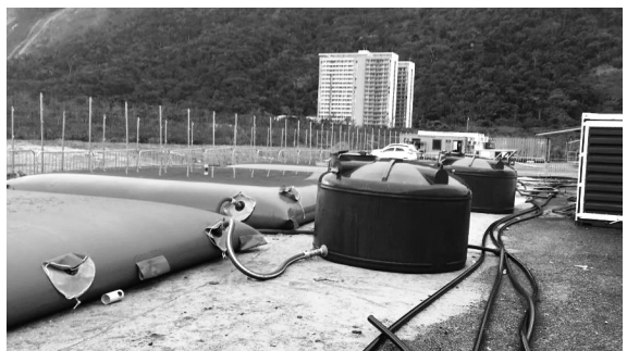
写真2 給水タンクと貯水バッグ(2016年リオオリンピック)
