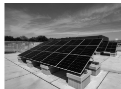
写真1 太陽光発電設備 (愛知県警察学校)
