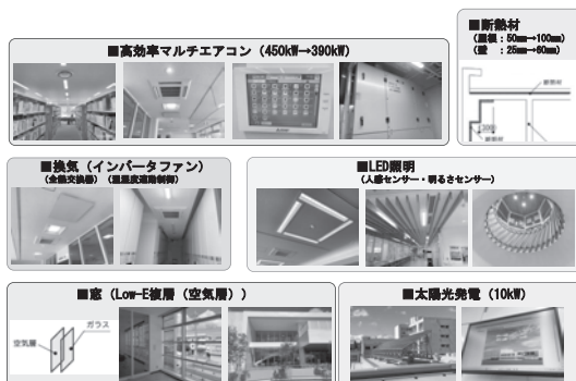
図6 福井市立図書館の省エネ建築・設備
