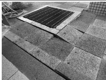
写真4 通路の沈下・段差 2)
