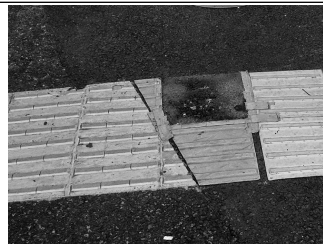
写真3 誘導ブロックの欠損 2)
