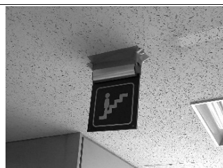
写真1 案内表示の脱落 1)
