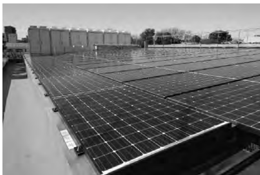
写真4 屋上に設置した太陽光発電
