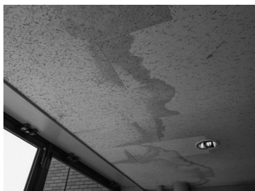
写真1 天井の漏水痕
