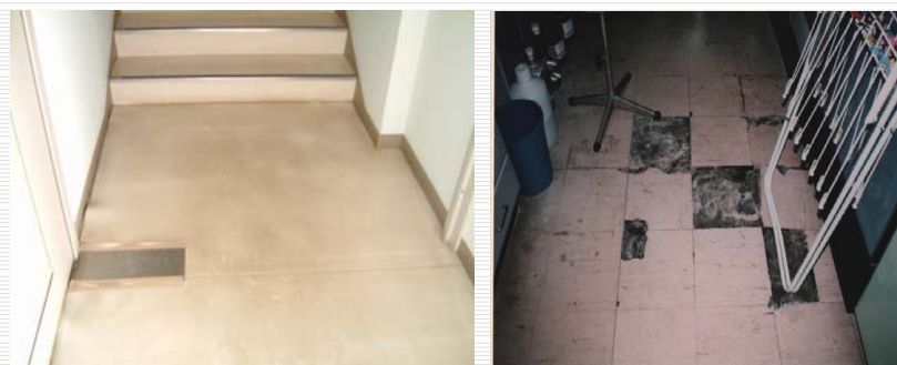
□ ビニル床シートのだわみ
